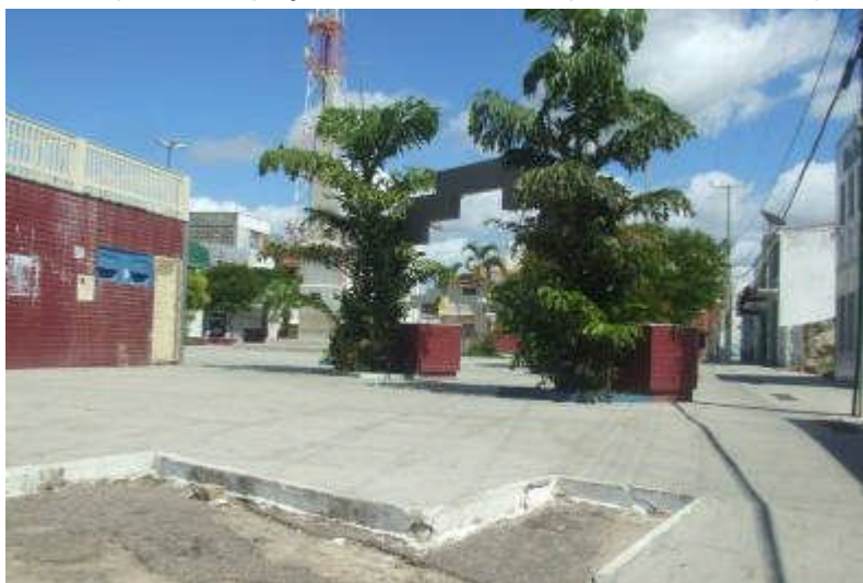
FIGURA 08. Rampa em Espaço Público fora dos padrões – Município de Macau.
