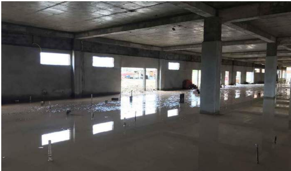
Foto 3 – Subsolo do Bloco “A” alagado no período chuvoso, sendo necessário o esgotamento com bombas, pois não há infiltração no solo argiloso com rochas calcárias.
