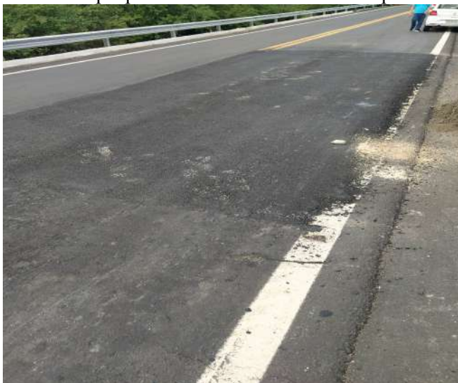
Figura 18 – Recalque próximo a cabeceira de 01 das pontes da RN-233
