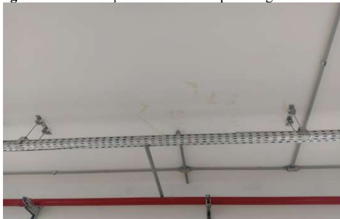
Figura 16 – Infiltração no teto do Hospital Regional de Assu
