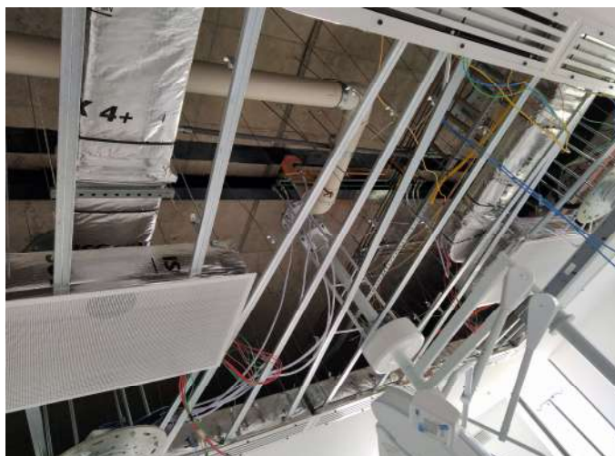
Figura 17 – Falta de fechamento no forro de gesso do Hospital Regional da Mulher
