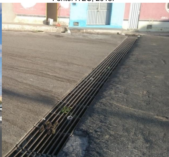
FOTO 38: DISPOSITIVO DE CAPTAÇÃO DE ÁGUAS PLUVIAIS EM VIA NA CIDADE DE APODI.
