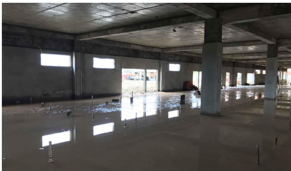
Foto 3 – Subsolo do Bloco “A” alagado no período chuvoso, sendo necessário o esgotamento com bombas, pois não há infiltração no solo argiloso com rochas calcárias.
